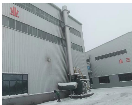
磨粉工序排气筒
