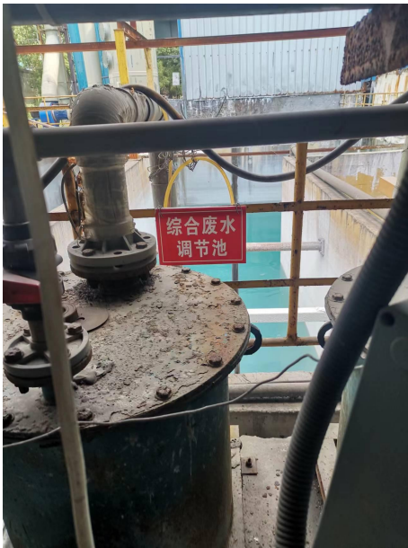
污水处理站调节池
