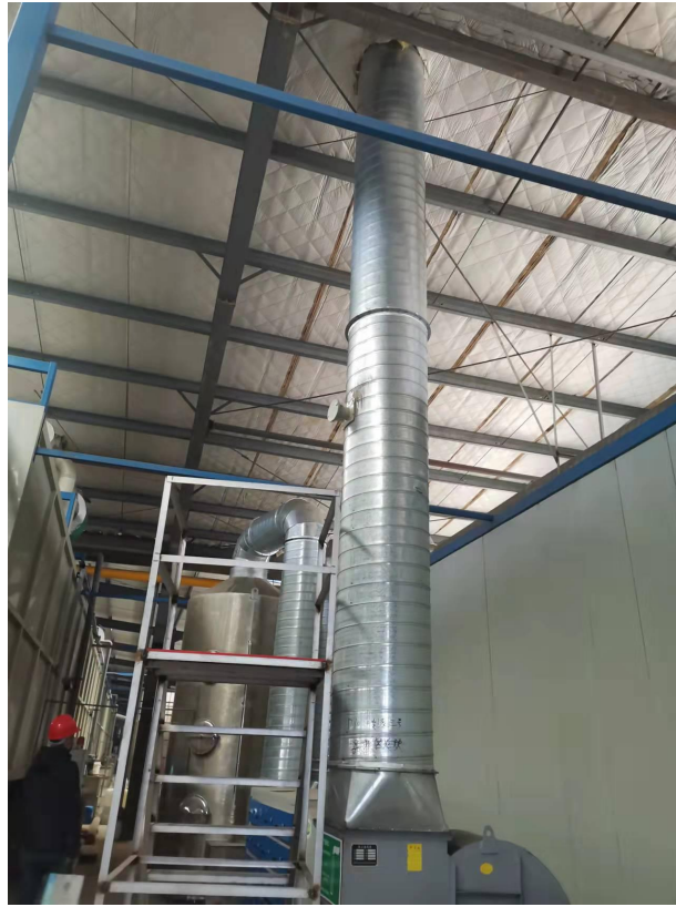
高效喷淋塔+活性炭吸附床+排气筒 晶泳固化废气处理措施
