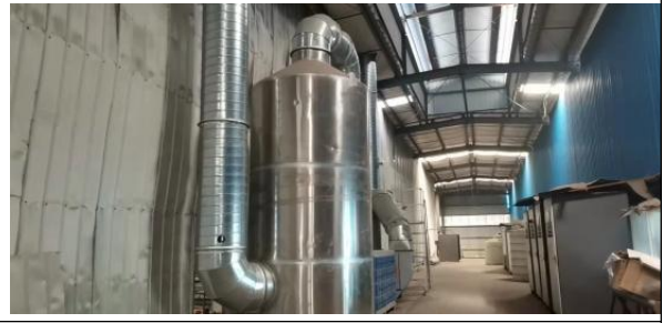
高效喷淋塔+活性炭吸附床+排气筒
