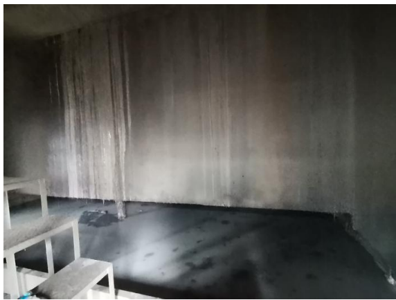
喷漆房水帘幕墙
