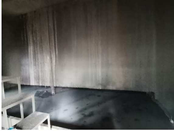
喷漆房水帘幕墙
