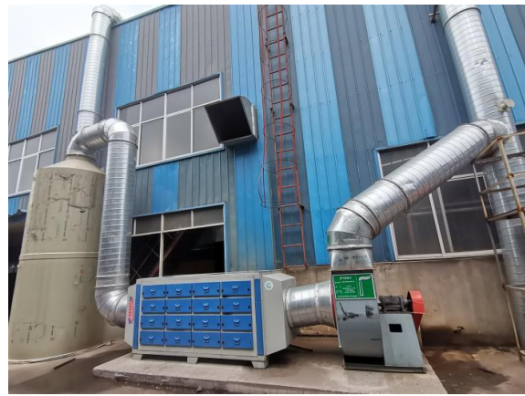
老立式喷涂固化废气处理设施
