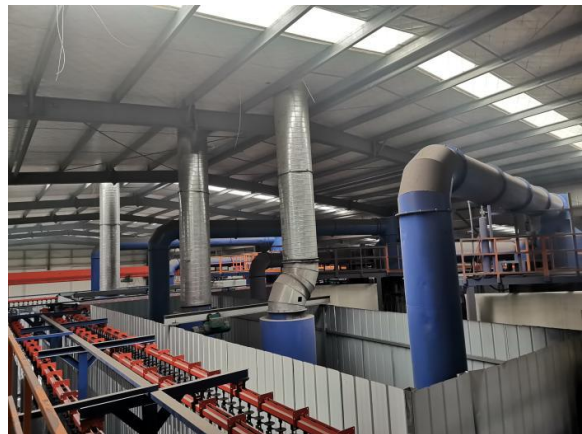
新立式喷涂喷粉废气排气筒
