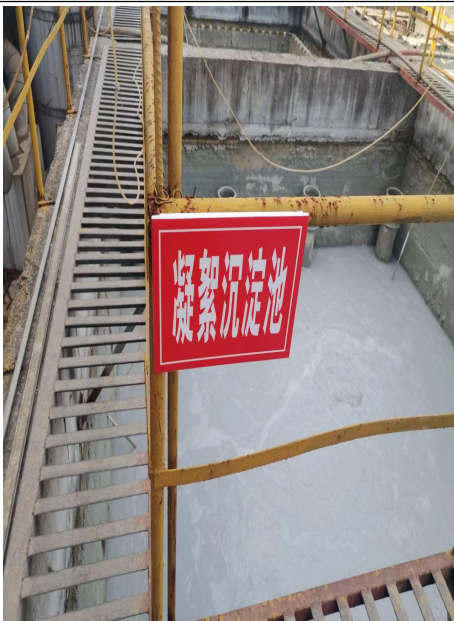
污水处理站絮凝沉淀池
