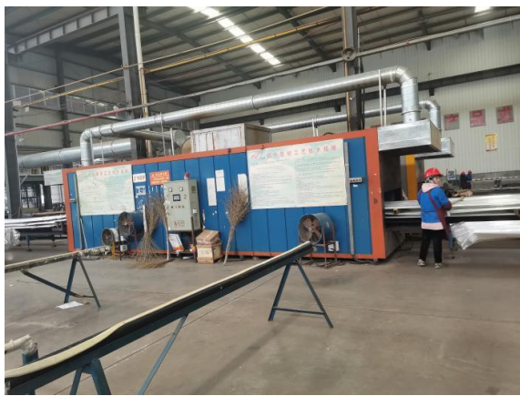
木纹炉废气收集管道
