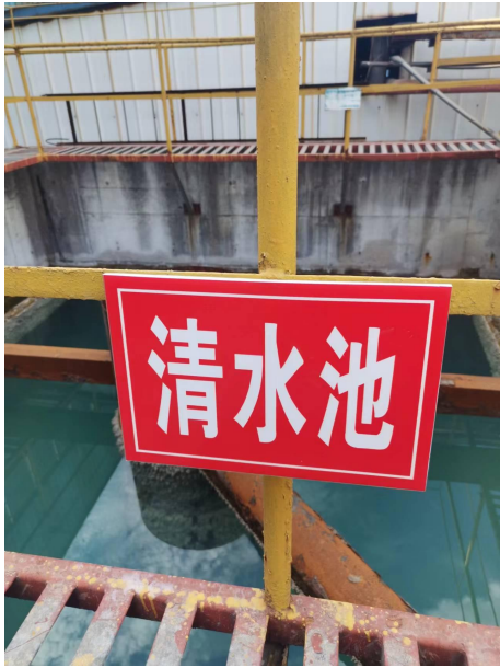
污水处理站清水池
