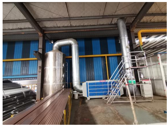
高效喷淋塔+活性炭吸附床+排气筒
