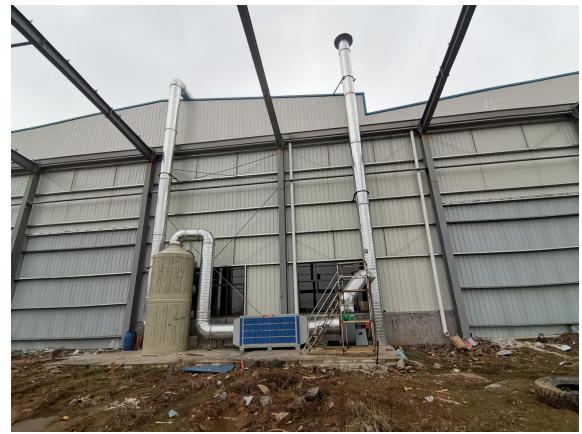
新老立式喷涂固化废气处理设施
