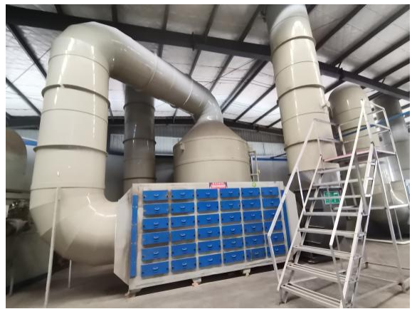
高效喷淋塔+活性炭吸附床+排气筒
