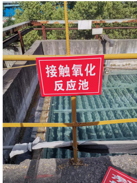
污水处理站氧化池
