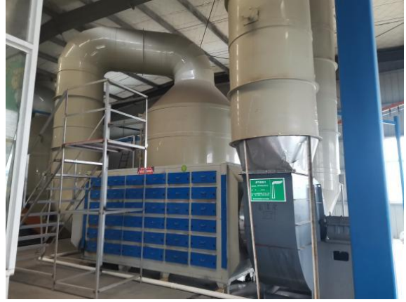
高效喷淋塔+活性炭吸附床+排气筒
