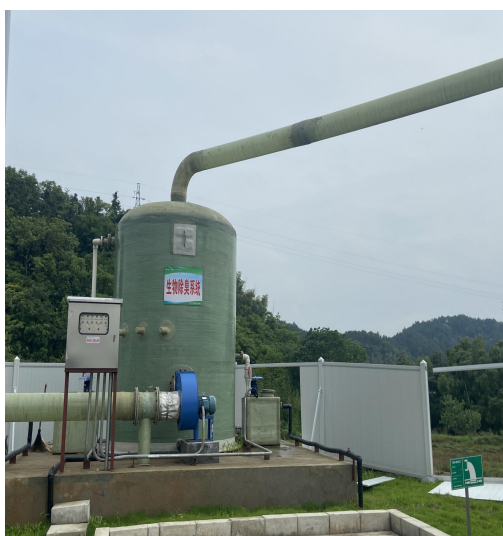
生物除臭系统
