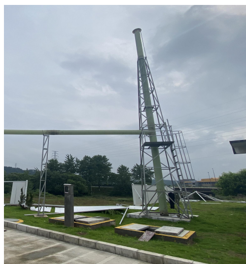
生物除臭系统排气筒
