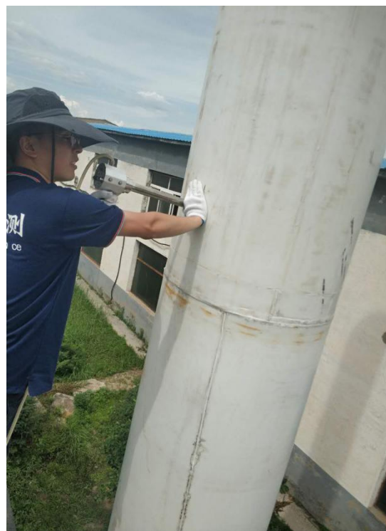
喷淋排气筒出口
