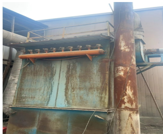
3.规边机、刨槽机、刨杆机除尘器
