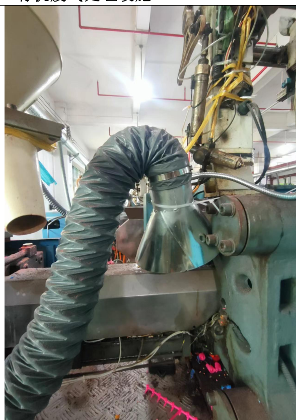
有机废气收集系统
