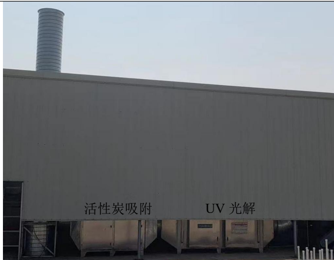
废气处理设备及废气排放口
