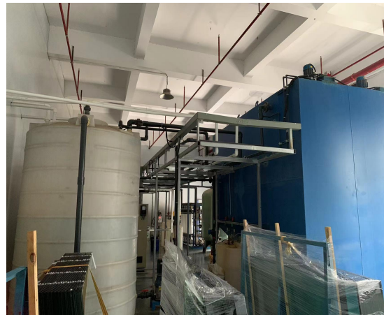
废水处理设备
