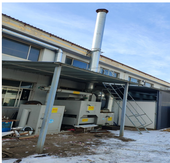
图 3-1 废气处理装置及排气筒
