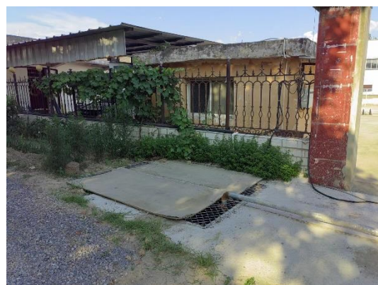
车辆冲洗废水收集沉淀池
