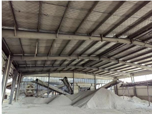
车间顶部喷淋装置
