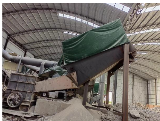
上料、破碎粉尘收集装置
