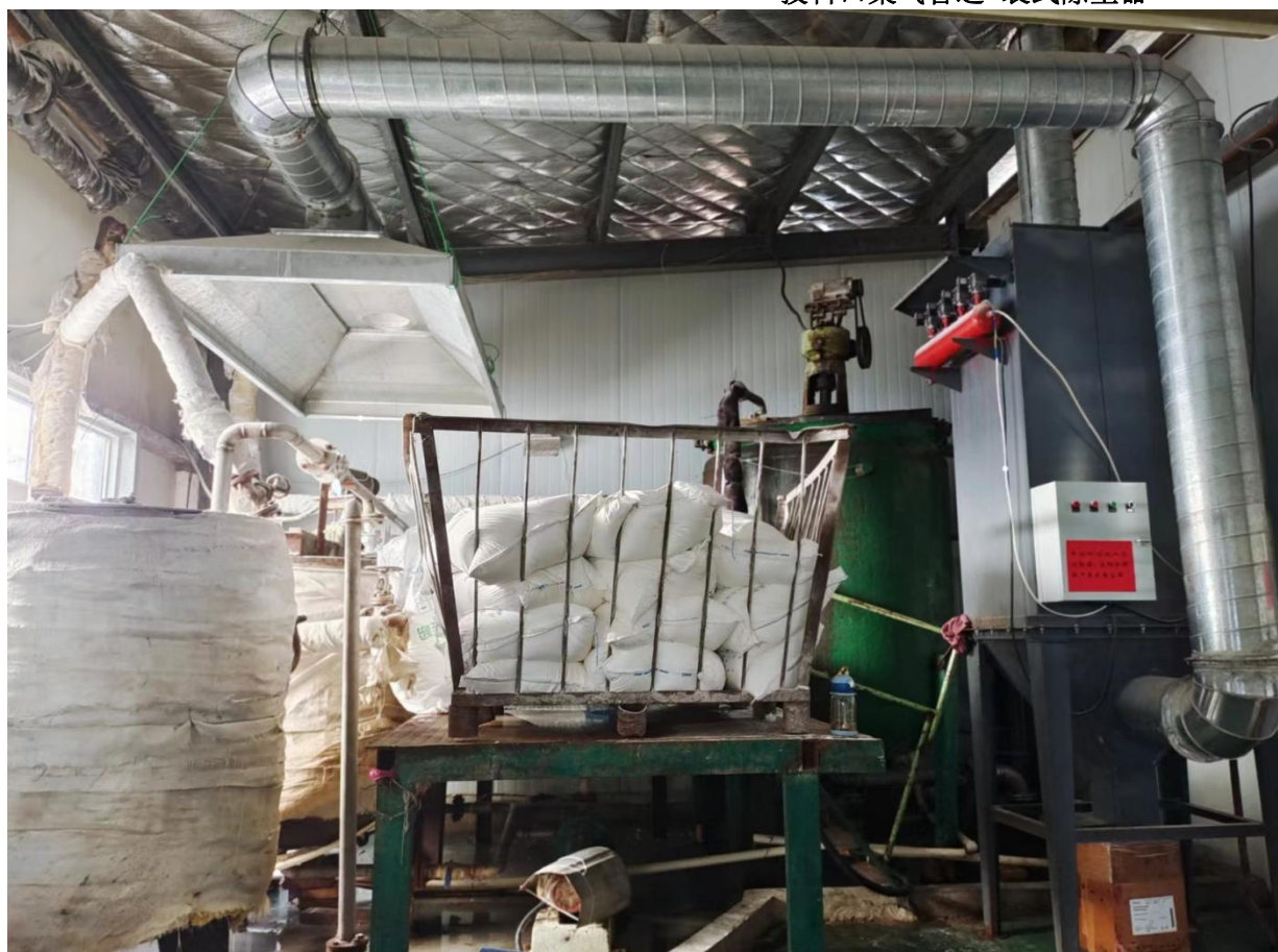
投料集气除尘装置
