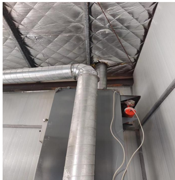
投料口集气管道+袋式除尘器
