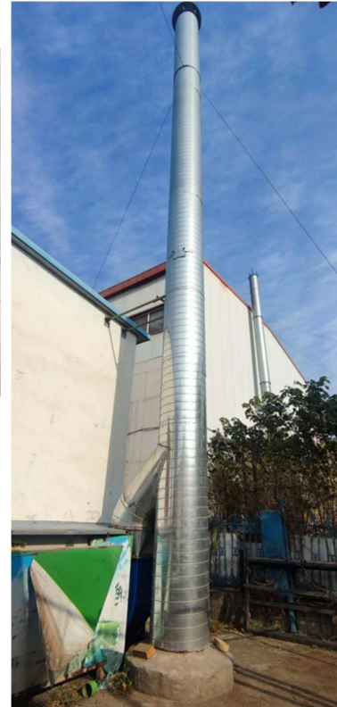
电泳、固化及热风炉废气排气筒 DA001
