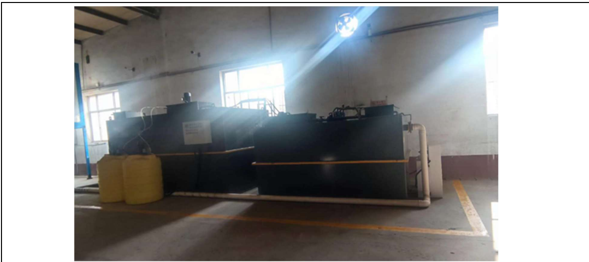
图 4-1 本项目生产废水污水处理站设施图
