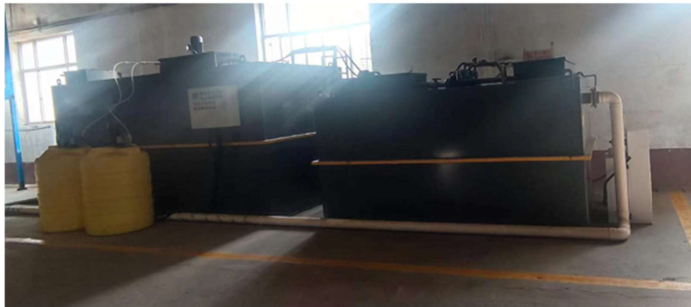
密闭的污水处理设备
