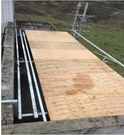
厌氧池/曝气池/沉淀池/消毒池
