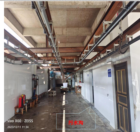
生产区污水沟
