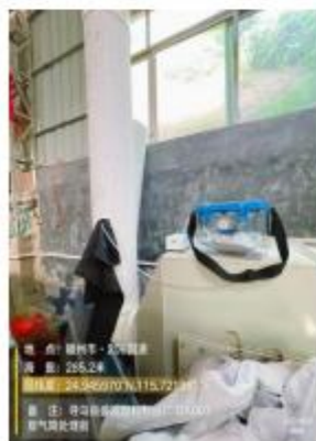
DA001 排气筒 (处理前)
