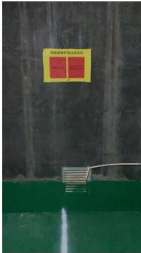
危废暂存间照片
