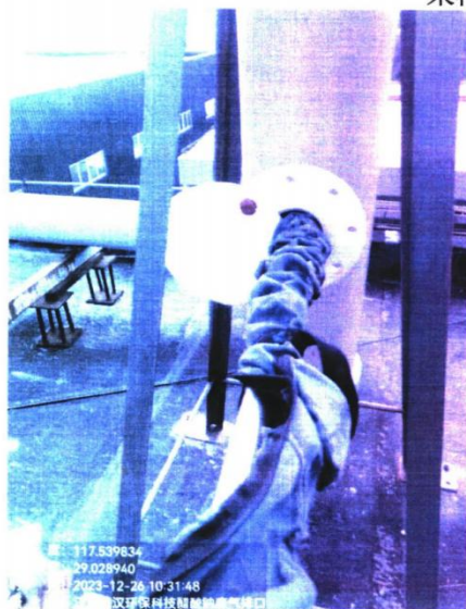
103 醋酸钠车间废气排口 Q1
