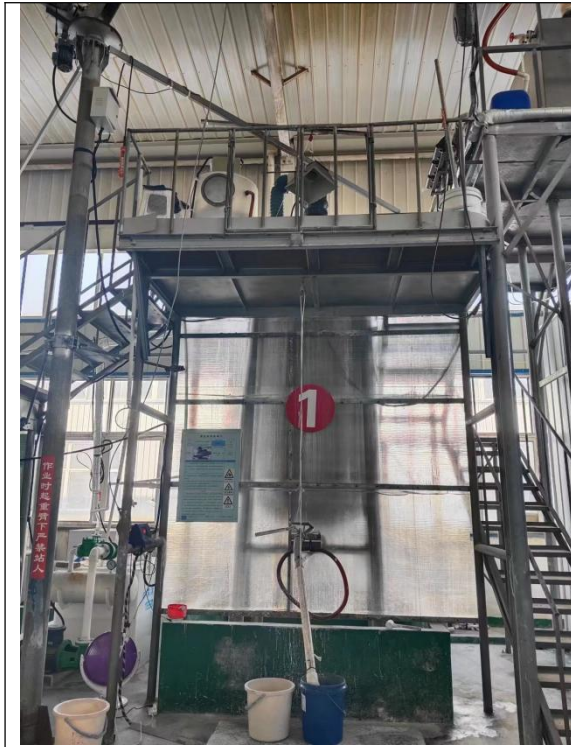
1#搅拌罐正常使用
