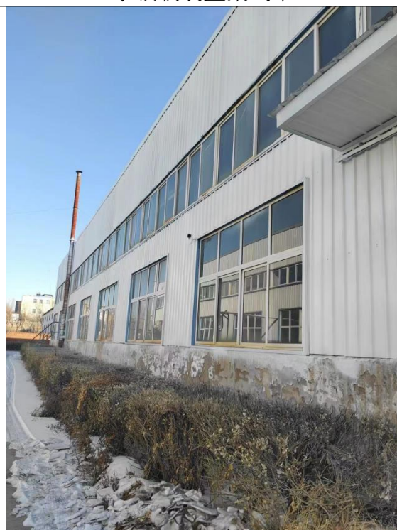
封闭生产车间
