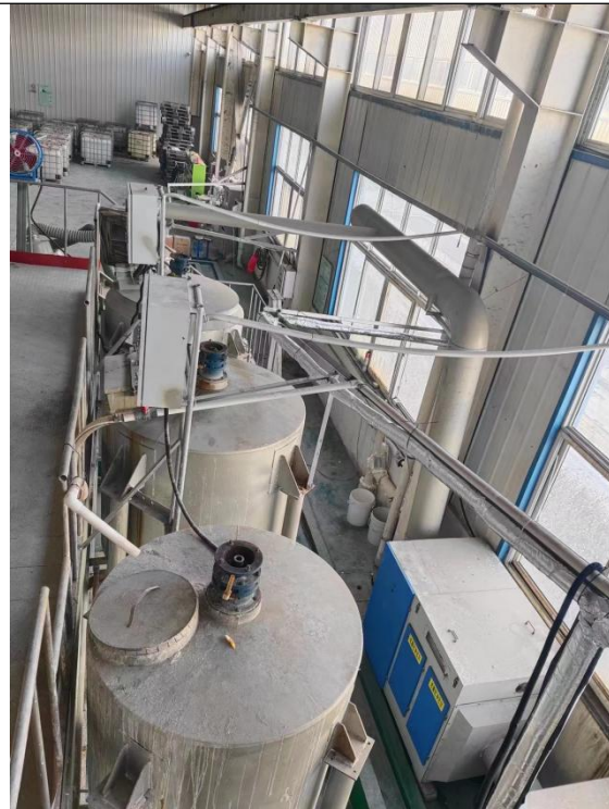
2#、3#搅拌罐动力设备未安装
