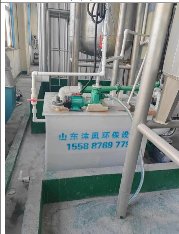
水吸收装置循环水箱
