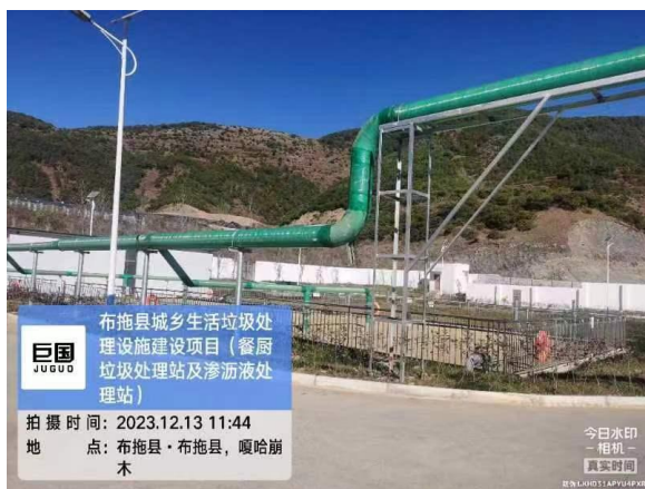
废气收集管道
