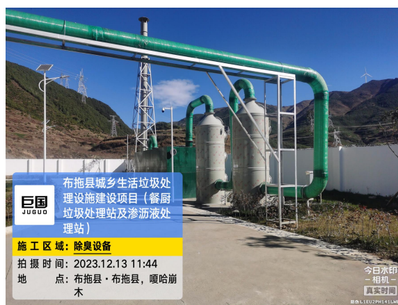
1 套碱洗塔+酸洗塔+生物滤池装置
