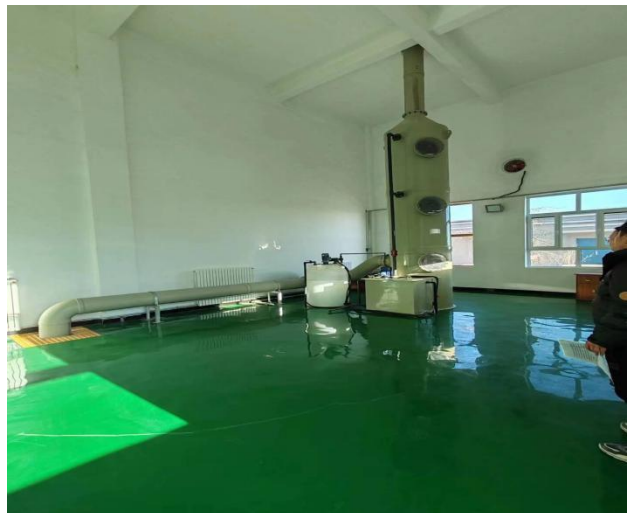
液氯事故应急塔
