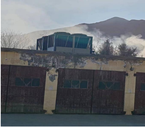
净水厂空气热源泵
