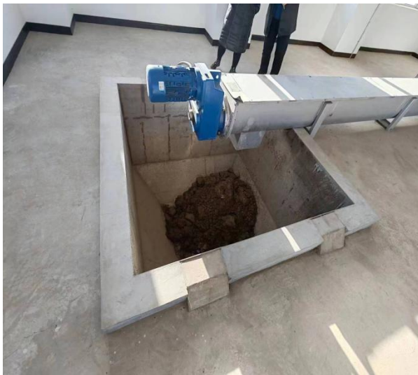
压滤机污泥排口
