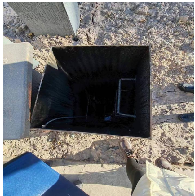
生活污水排口
