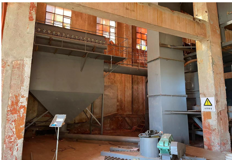
2 车间布袋除尘器
