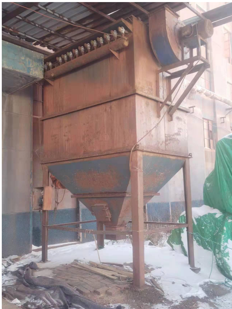
1 车间布袋除尘器
