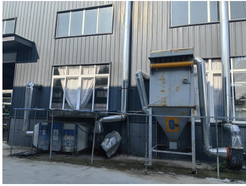
废气处理设施
