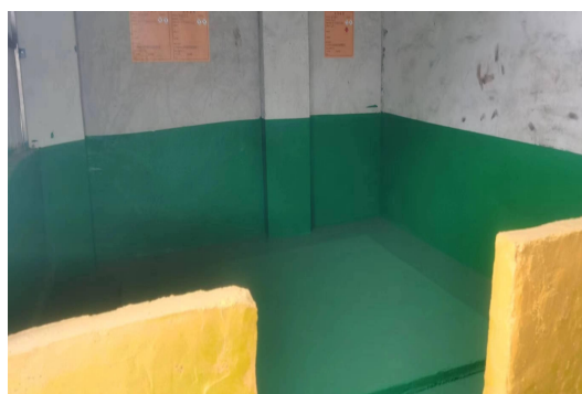
危废间收集沟
