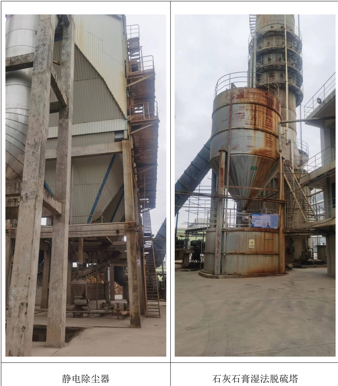
图 4.1-6 锅炉废气处理设施照片
