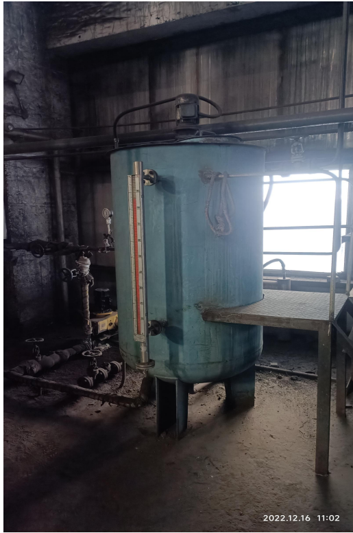
SNCR 脱硝设备
