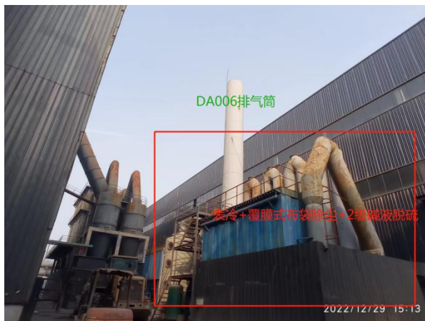
废气处理措施+DA006 排气筒
