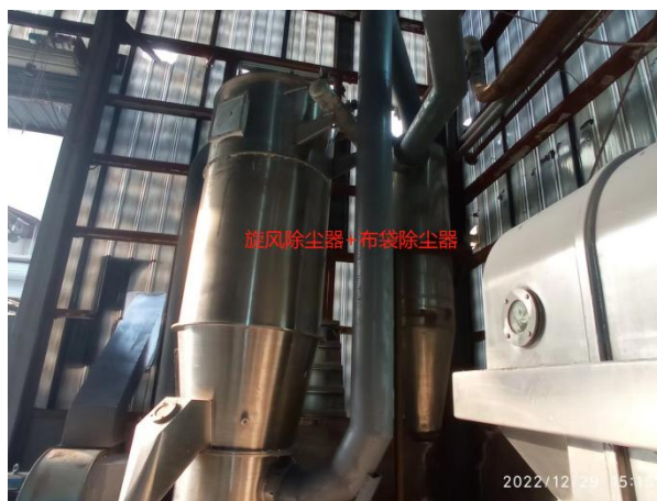
废气处理措施
