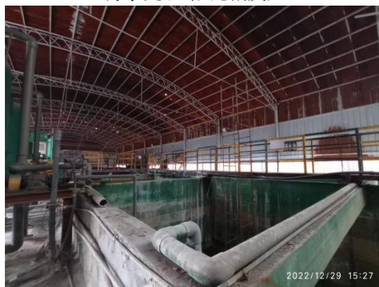
污水处理站-清水池
