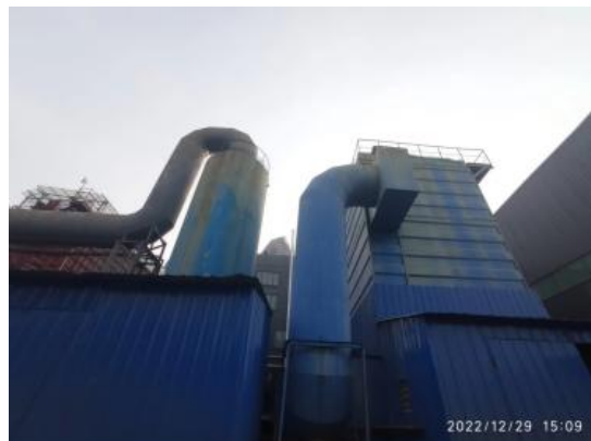
覆膜式布袋除尘+碱液喷淋系统
