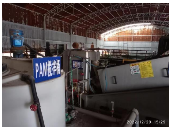
污水处理站-污泥处理设备
