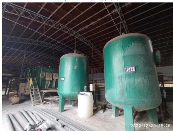
污水处理站-过滤罐
