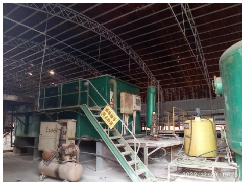
污水处理站-混凝反应
