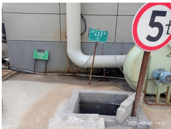
地下水监控井 (3)
