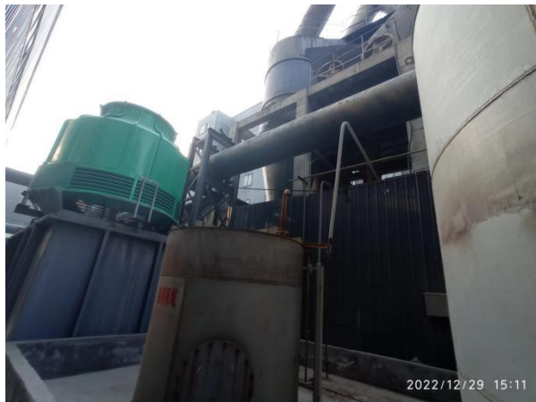
SNCR 脱硝系统
