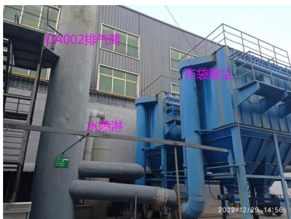
废气处理措施+DA002 排气筒
