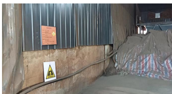
氧化锌浸出渣贮存格间
