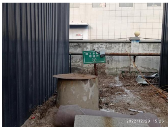
地下水监控井 (1)
