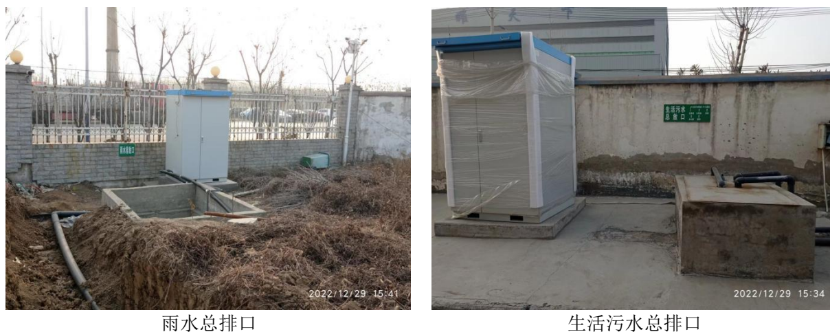
图 4.1-3 废水治理设施照片
