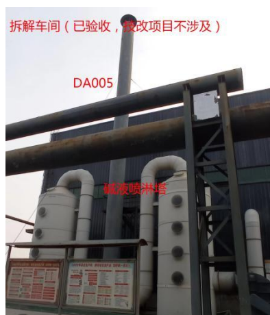
拆解车间废气处理设施
