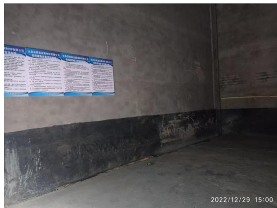
危废暂存库 (1) -重点防渗、制度上墙
