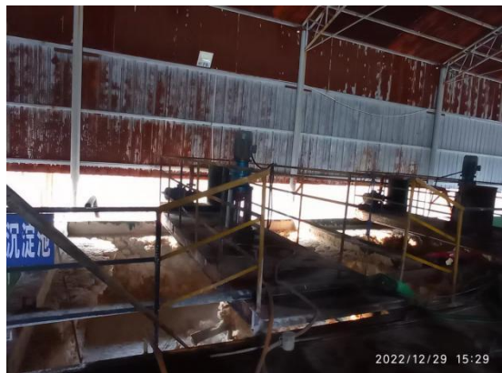
污水处理站-沉淀池
