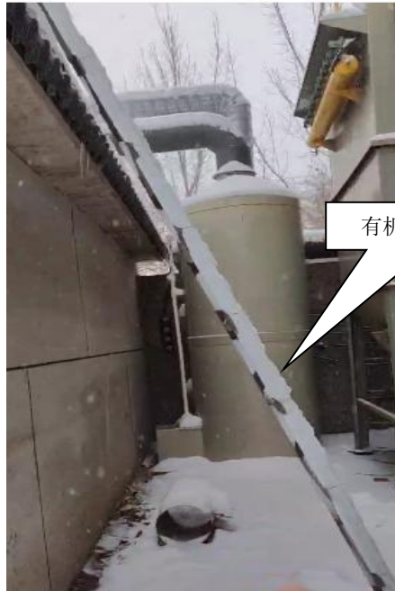
水喷淋+低温等离子净化+活性炭吸附装置
