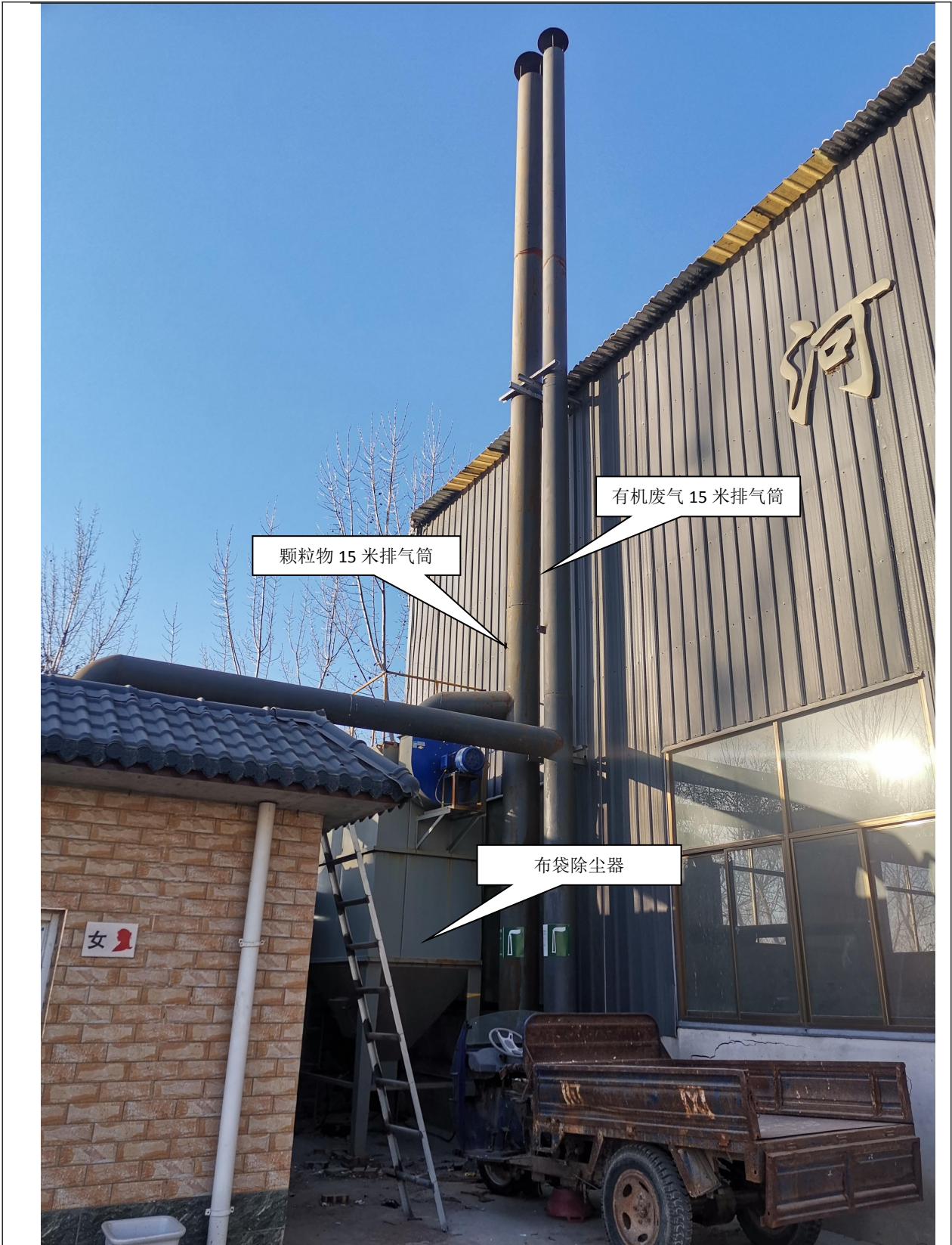
布袋除尘器+15m 高排气筒
