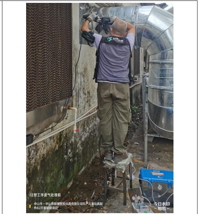
注塑工序废气处理前 10#
