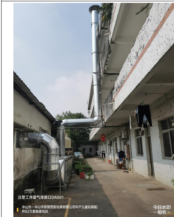
注塑工序废气排放口 11#
