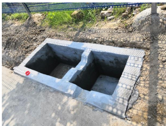
进出厂车辆清洗废水沉淀池
