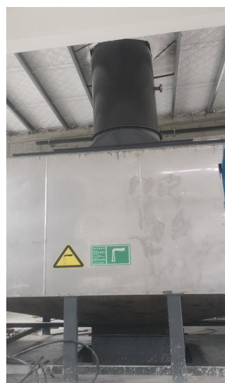
湿法干燥废气排放口
