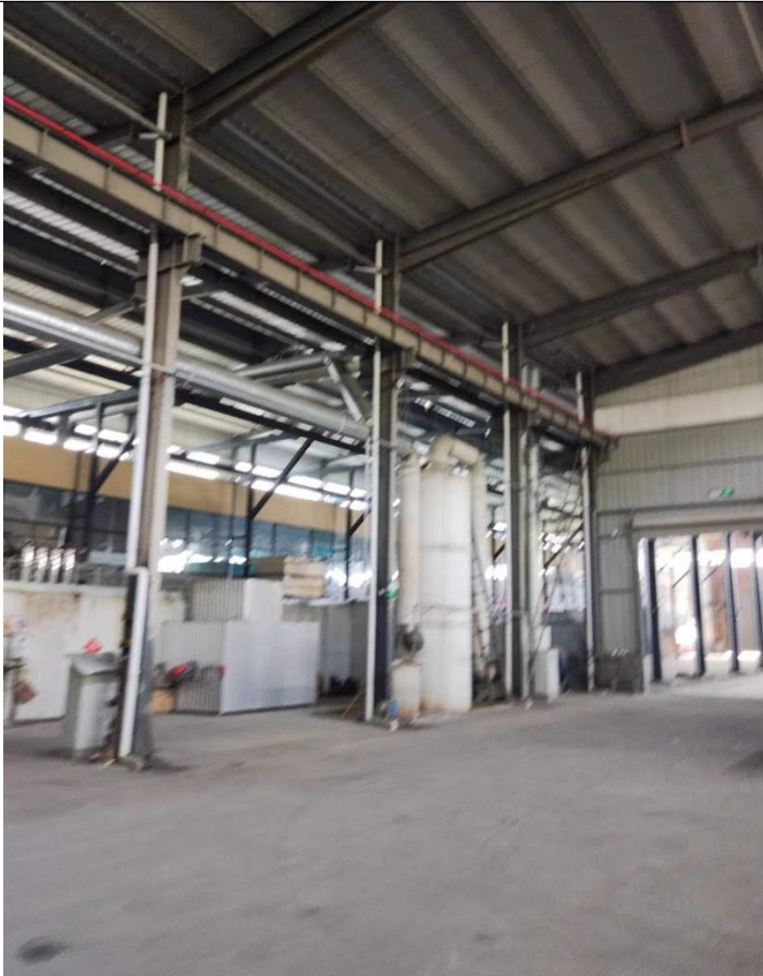
碱液吸收+二级活性炭吸附装置
