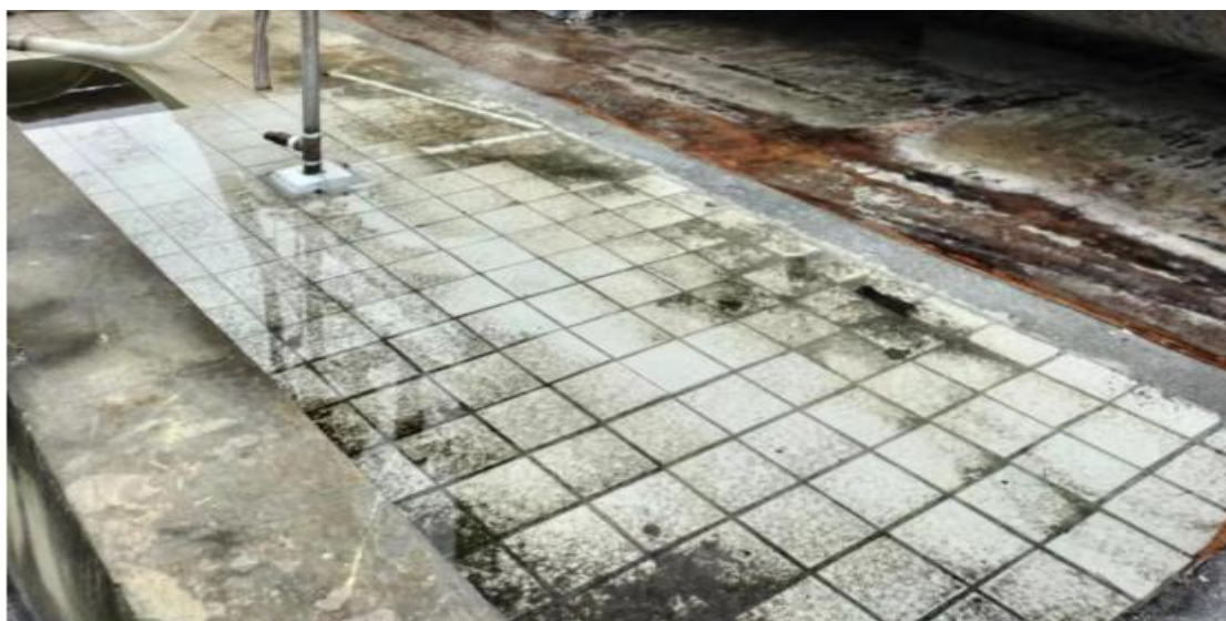
硫酸罐区防腐措施
