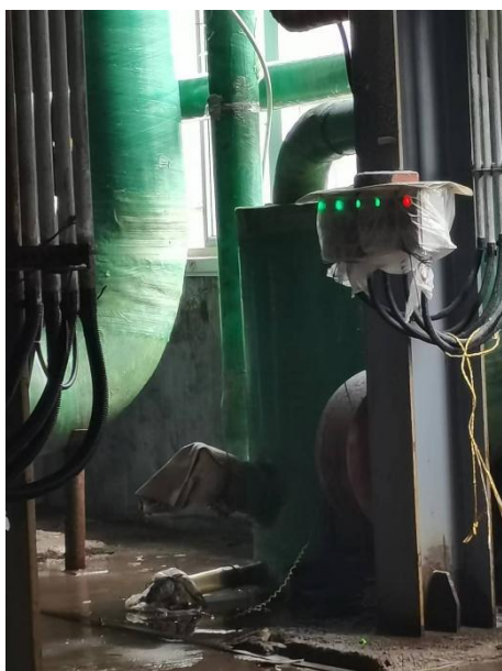
风干废气水浴吸收处理装置
