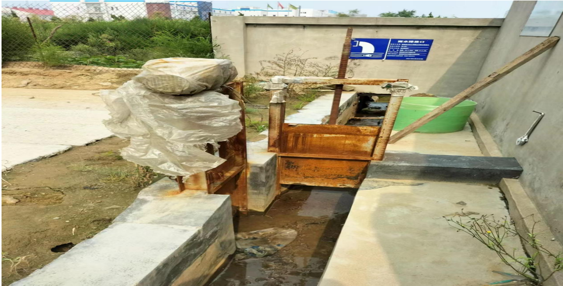
雨水总排口及切换阀
