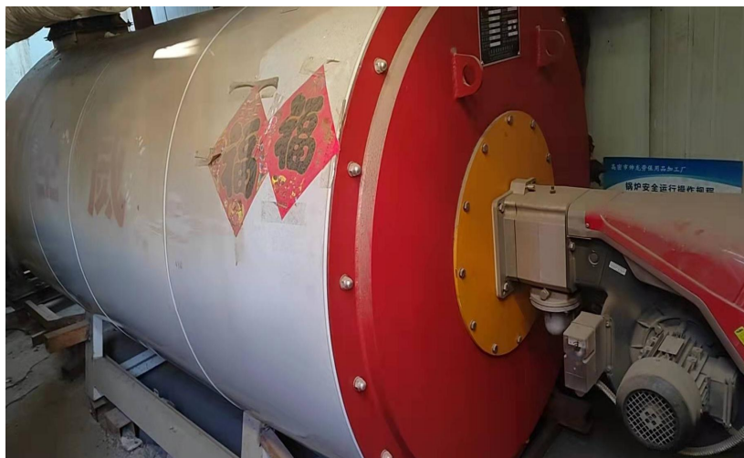
配备超低氮燃烧器的天然气锅炉
